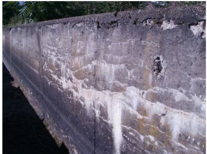
写真-1 凍害損傷が顕在化した用水路
